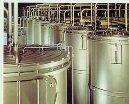
第2 運転単位の遠心分離機
